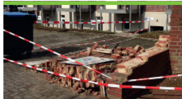
Aus Gründen der Sicherheit rissen unsere Handwerker am 10. März die Mauer ab, die von einem LKW umgefahren worden war.
